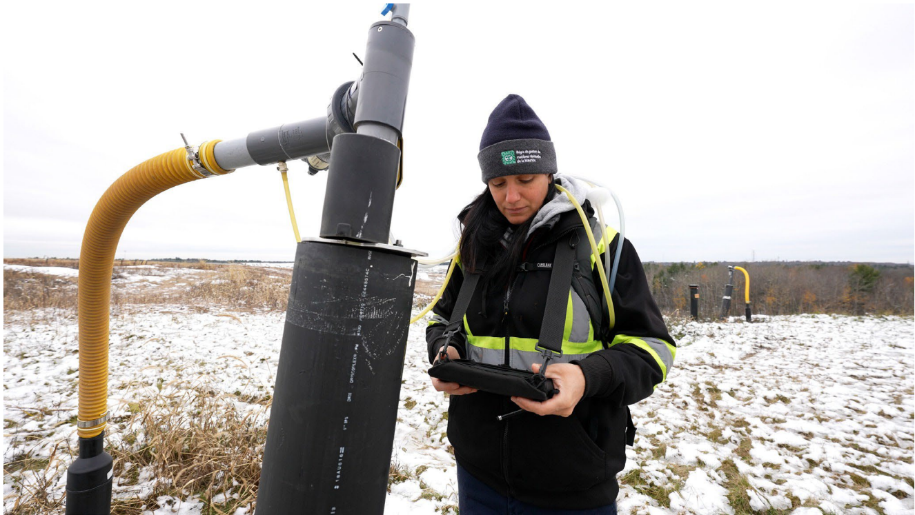
Mesure de la composition du gaz sur un puit de captage du site de Saint-Étienne-des-Grès – Canada (photo Enercycle)
