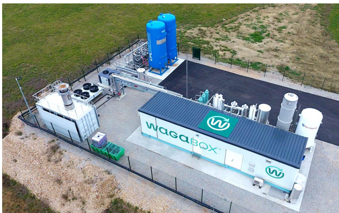
Fig. 34: L'unité WAGABOX® installée sur le site Suez de Les Ventes-de-Bourse
