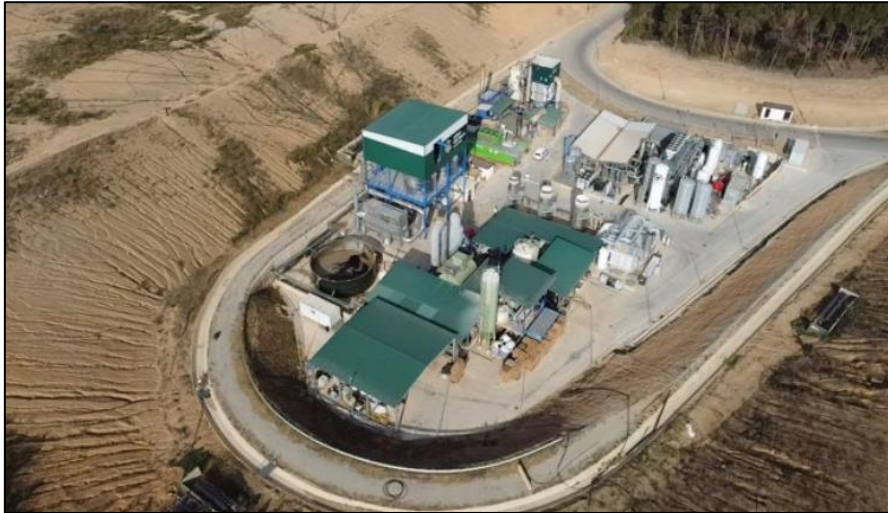
Vista general de la zona de gestión del biogás donde se ha implantado la unidad de producción de biometano en el Depósito Controlado de Can Mata (Barcelona)
