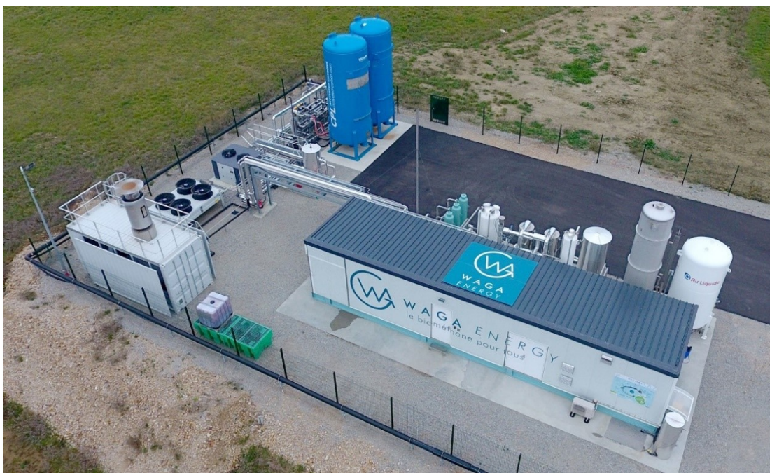
Fig. 35: L'unité WAGABOX® installée sur le site Suez de Les Ventes-de-Bourse
