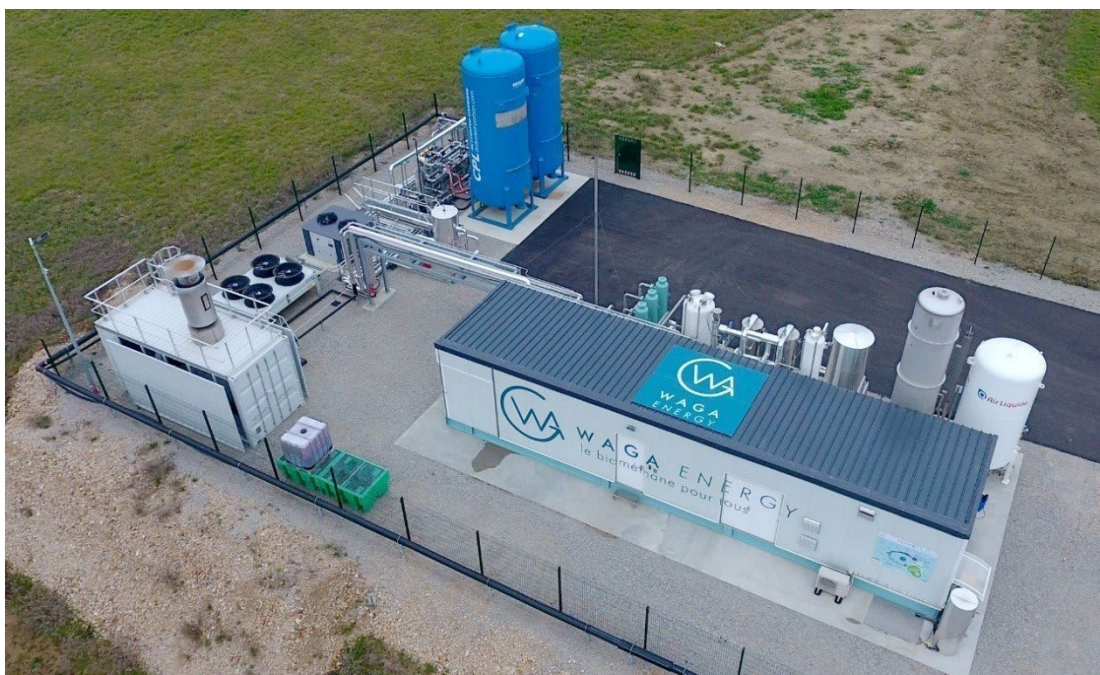
Fig. 33: L'unité WAGABOX® installée sur le site Suez de Les Ventes-de-Bourse
