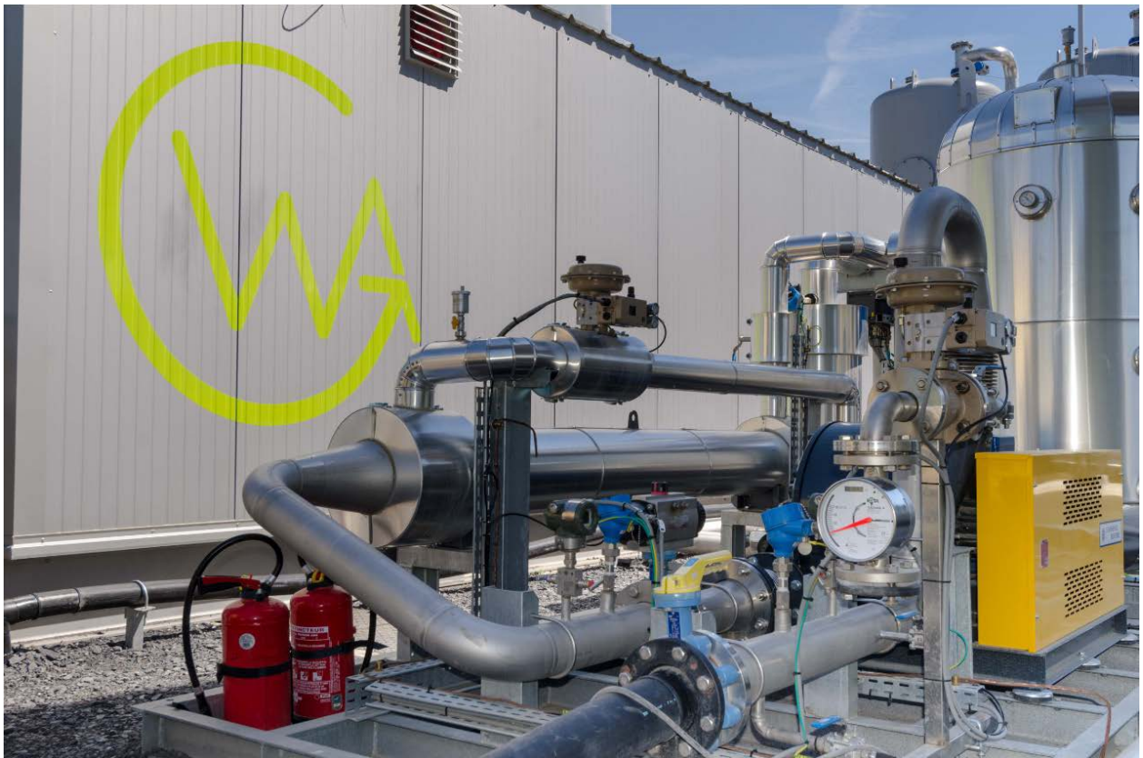
Fig. 33: Caractéristiques d'une unité WAGABOX® – exemple d'une unité de 1 500m 3 /h
