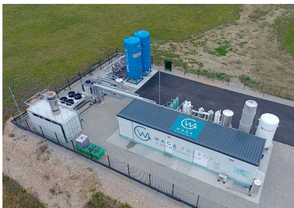
Vista aérea de la unidad WAGABOX® en funcionamiento desde enero de 2020 en el vertedero de Ventes-de-Bourse (Orme) operada por Suez © Waga Energy
